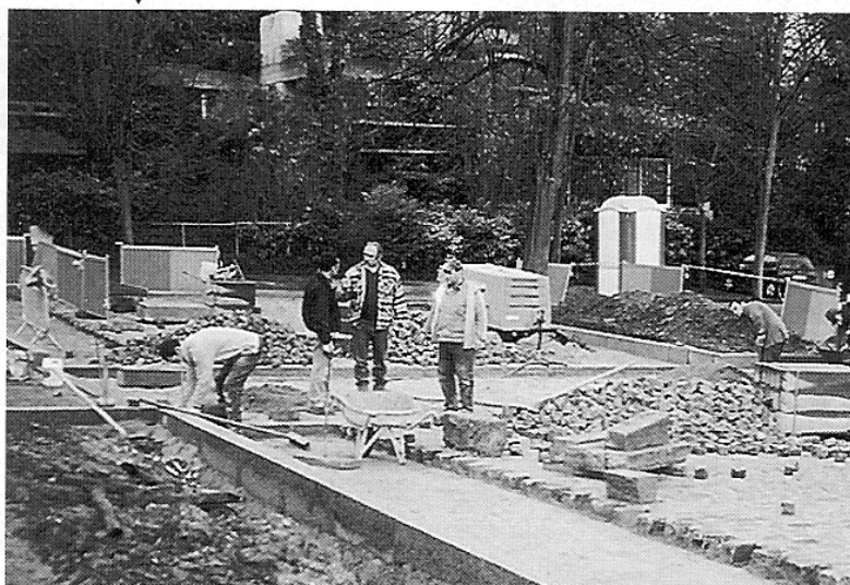
▼ 92 - Hauts-de-Seine. Meudon. Avenue du Château. La réfection de la chaussée centrale pavée s'est terminée en avril 2000. La réfection des contre-allées, la rénovation de la place Janssen et la suite des plantations s'étaleront jusqu'en 2013. (Photo : AAAC - janvier 2004)
